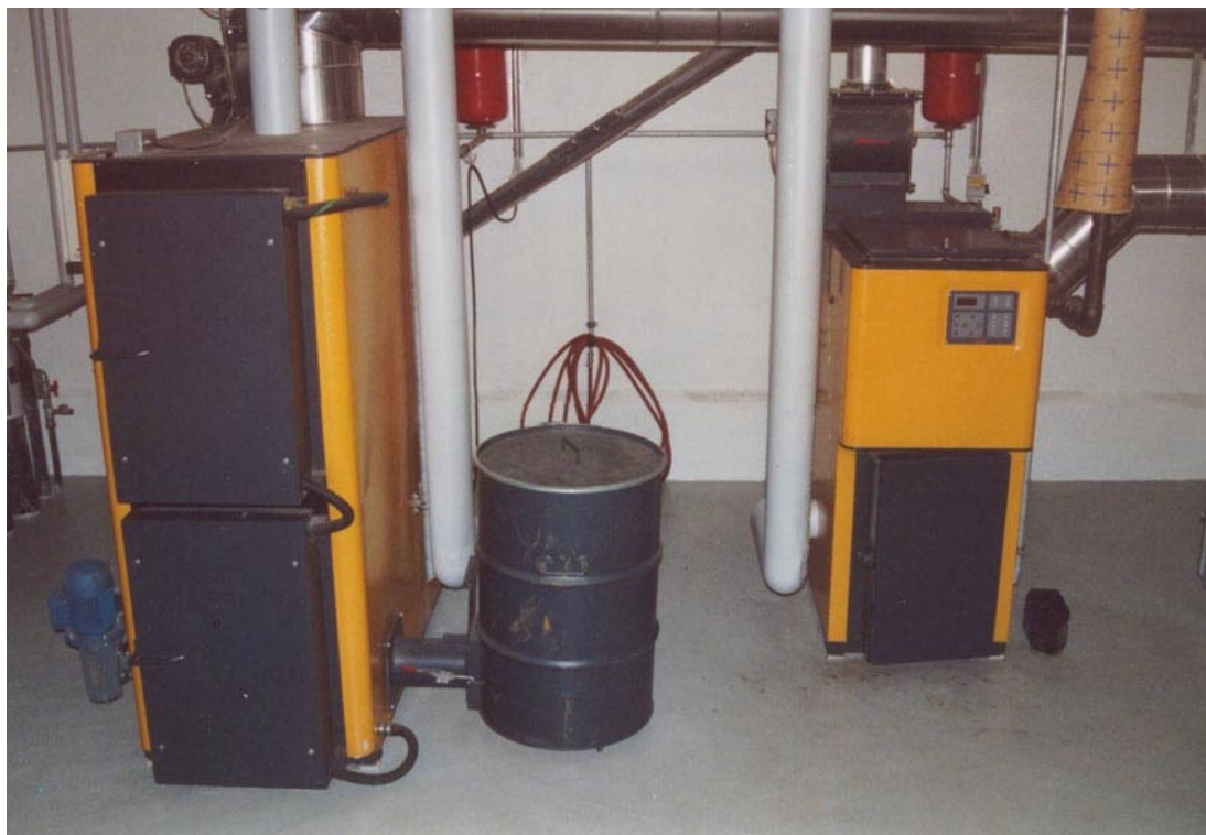
Figuur 5.6 Bij een Deense school zijn twee pelletkachels naast elkaar geïnstalleerd, zodat de kachels bij iedere warmtevraag optimaal kunnen worden bedreven.
